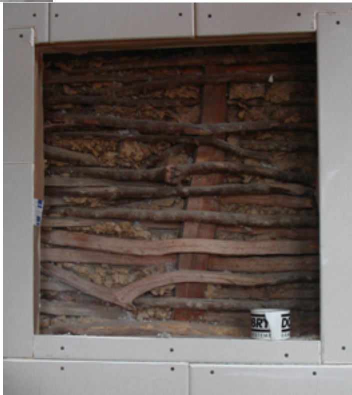
Einer der schönsten Blickfang im zukünftigen Zimmer ist die alte Wandfüllung, die noch hinter Glas
